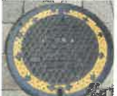
貯水槽用マンホール
