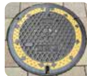
消火栓マンホール
