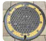
消火栓マンホール
